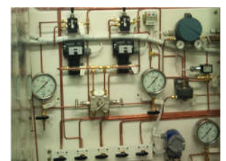
Detalhe dos circuitos pneumáticos
